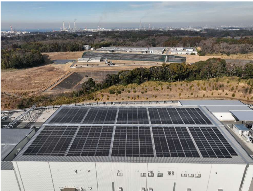
【太陽光パネル設置箇所】
